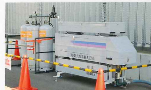
移動式ガス発生設備
