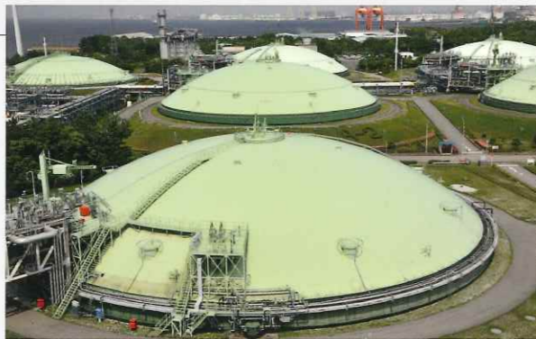
LNGタンク外観
