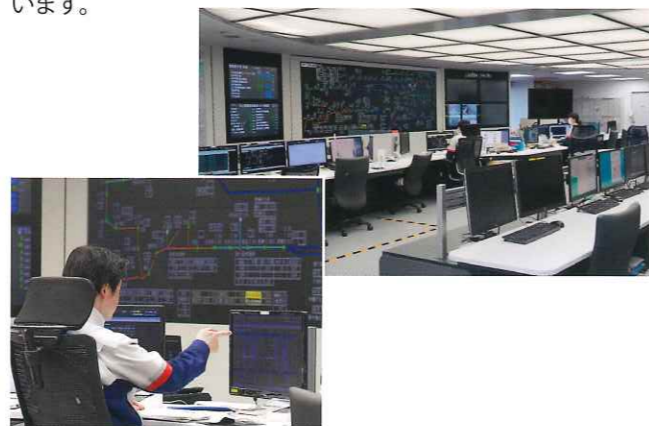
供給指令センター
