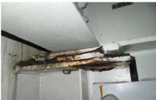
南口駅前センターデッキCDブロック 腐食
