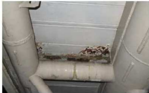
北口駅前広場デッキCブロック 腐食
