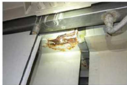
北口モノ下デッキBブロック 腐食
