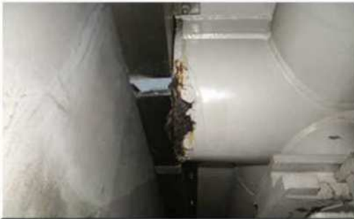
北口駅前広場デッキCブロック 腐食
