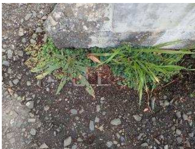
写真 3-1 1 排水ますの土砂詰まり
