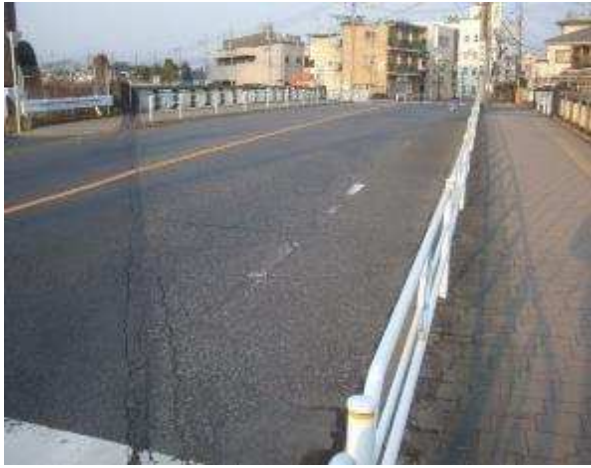
写真 1-1 中央橋補修工事前
