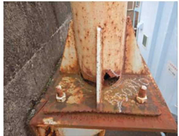
写真 3-8 砂川歩道橋：照明灯基部の孔食
