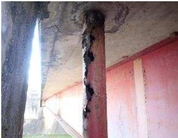
写真 3-9 馬場坂下橋：排水管の著しい腐食
