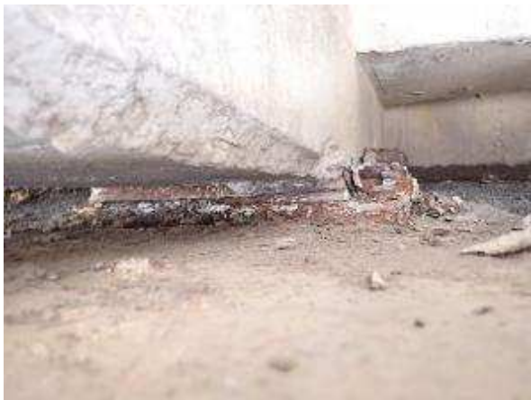
写真 3-7 富士見橋：支承・アンカーボルトの著しい腐食
