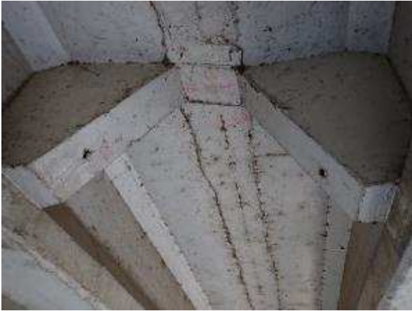
写真 3-5 富士見橋：横桁欠落
