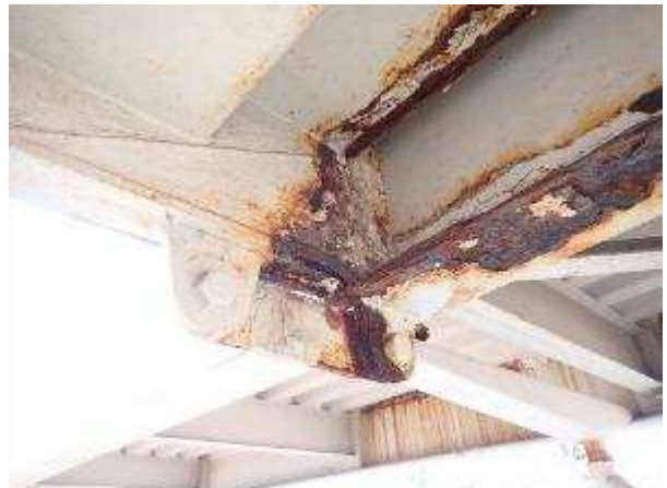
写真 3-10 松中団地第二歩道橋土見橋：階段接合部の腐食
