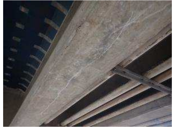
写真 3-6 富士見高架橋：主桁 PC 鋼線に沿ったひびわれ
