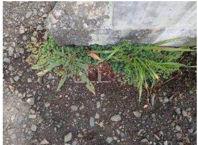
清掃が必要な排水ますの土砂詰まり
