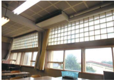
普通教室に設置されているクーラー
