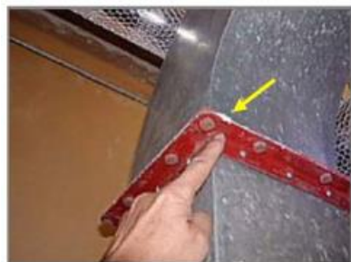
空調ダクトパッキン (ダクトの間に挟まっている白いもの)
