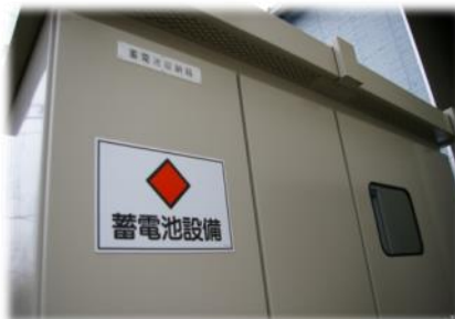
蓄電システム
