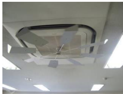
省エネ型空調機
