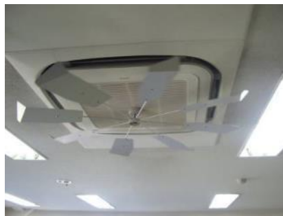
省エネ型空調機
