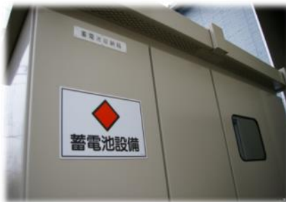
蓄電システム
