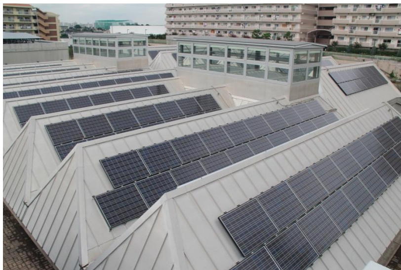
太陽光発電システム (市役所屋上)
