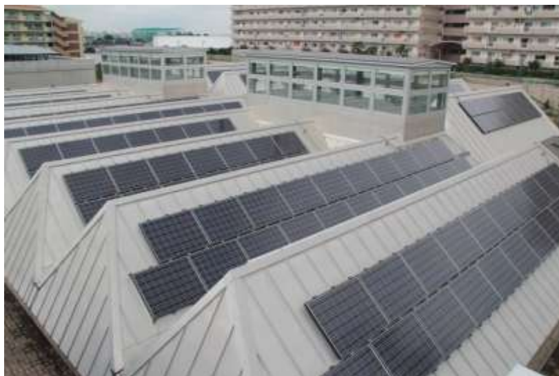
太陽光発電システム (市役所屋上)
