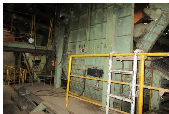
一次破碎設備（現在）
