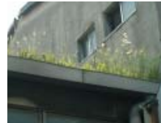
◆雨どい、排水パイプのつまり
