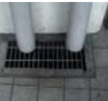
建物の排水ます
