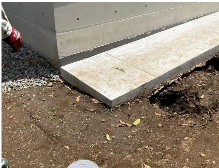
陥没発生状況(位置図②)
