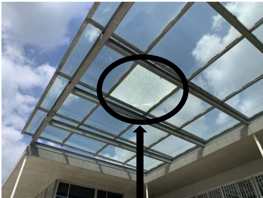
ひびが入ったガラス
