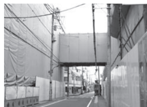
ブリッジは地上からの高さが約7メートル、長さ約12メートル。校舎棟と学習館棟を地上3階で結びます。
