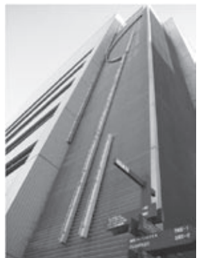
劣化で点灯しなくなった 「Tessera（テセラ）-4」
