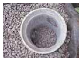
雨水浸透ます
