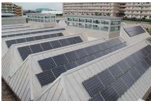
庁舎屋上の太陽光パネル
