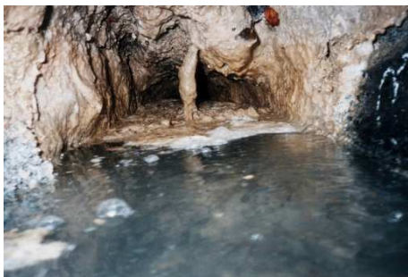
図 4-31 油が詰まった下水道管
