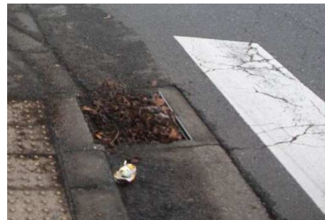
図 4-32 落ち葉の詰まった雨水ます
