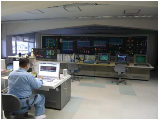
図 4-25 錦町下水処理場の中央監視室
