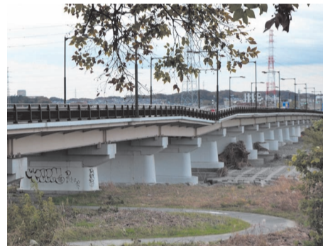
損壊した日野橋
