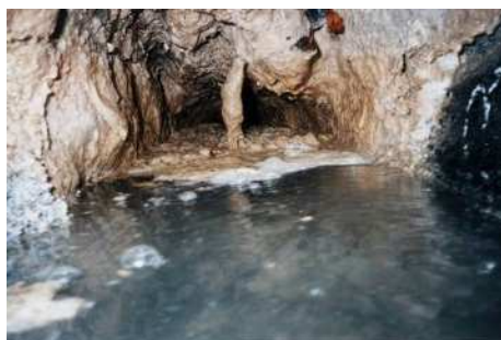
図 4-31 油が詰まった下水道管
