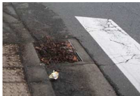
図 4-32 落ち葉の詰まった雨水ます
