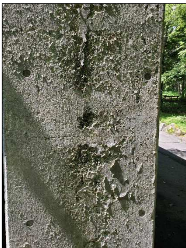
体育館・外壁の劣化
