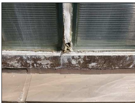
窓枠部分・シーリングの痛み
