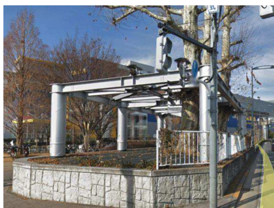
写真：樹木保護（支柱）の例（2級4号線）
