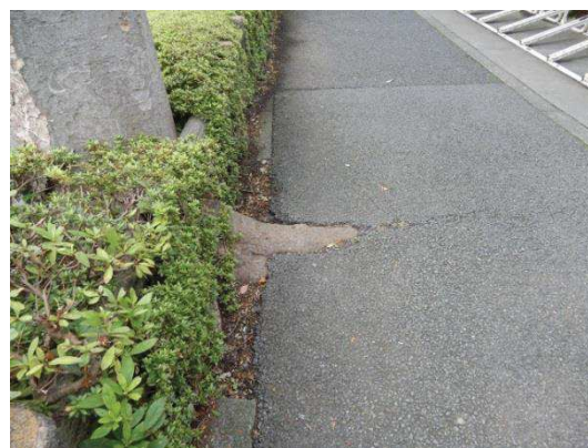
写真：根上がりの状態（舗装の損傷）
