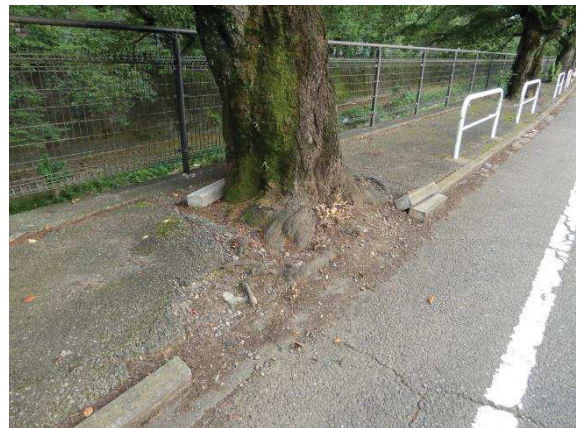
写真：根上りにより損傷した縁石・舗装（西73号線）
