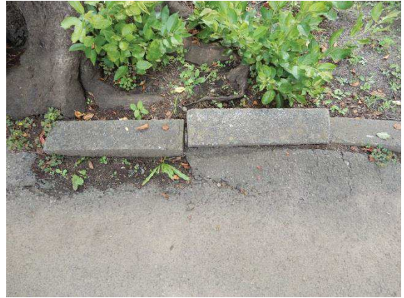
写真：根上がりにより損傷した縁石・舗装（中2号線）
