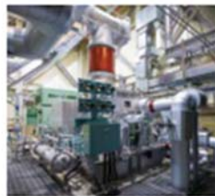
蒸気タービンと燃気タービン発電機
