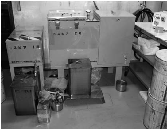
溶剤回収・再生装置
