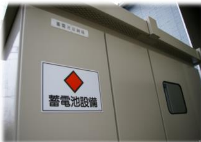
蓄電システム
