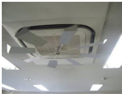
省エネ型空調機
