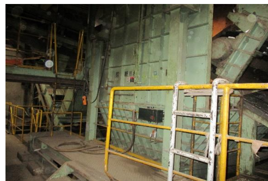
一次破碎設備（現在）
