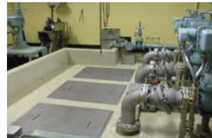
柏町汚水中継ポンプ場 市内には4か所の汚水ポンプ施設があります
