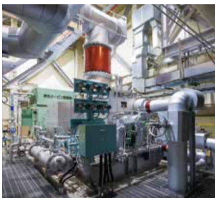
蒸気タービンと蒸気タービン発電機
