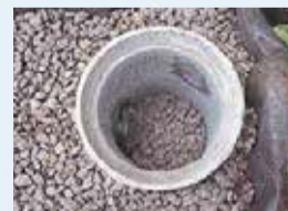
雨水浸透ます
