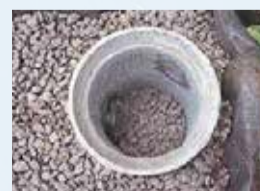
雨水浸透ます
