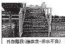
外部階段(舗装・排水不良)
