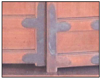
⑧棧唐戸金物破損
