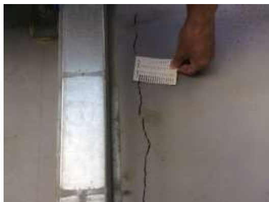
< ひび割れ幅最大約 2 mm >
