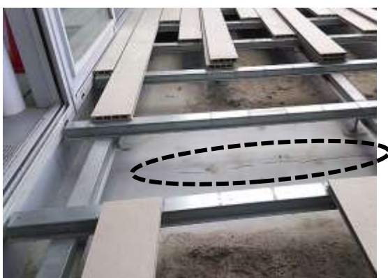
< ひび割れ状況 >
