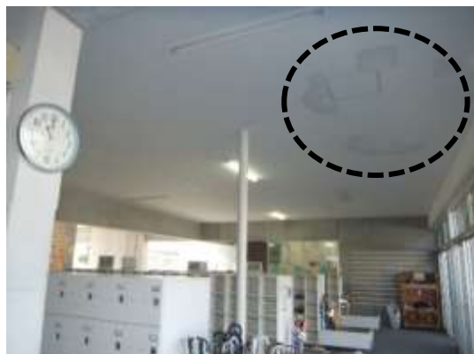
< 下階（1階）天井に漏水 >
