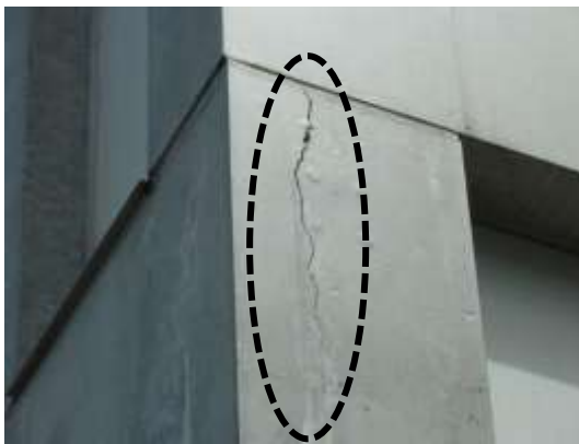
<ひび割れ状況>
