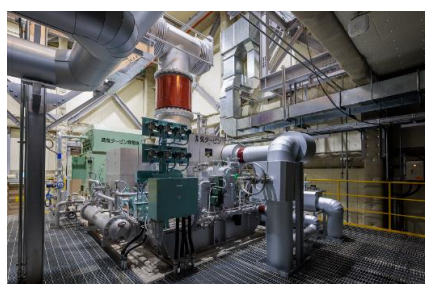
蒸気タービン発電機
